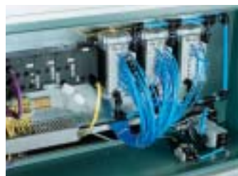
Von der zentralen Steuerung über Profibus-DP angesteuert enthält jedes Anlagenmodul eine Peripherieeinheit Simatic ET 200X mit Pneumatik-Interface
